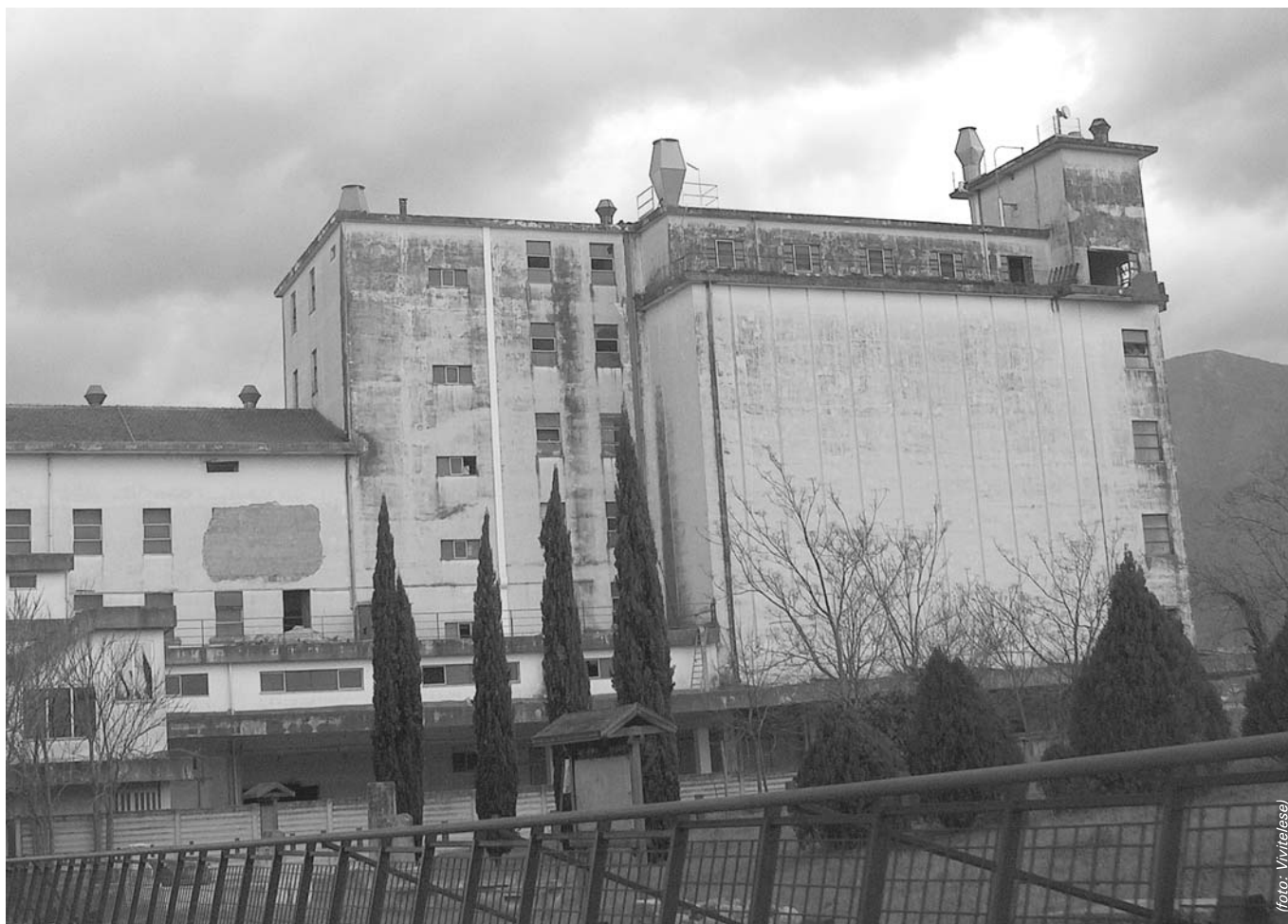
L'ex mulino Capasso & Romano che l'amministrazione vuole trasformare in liceo. Sul tetto, sono visibili, mascherate da comignoli, antenne per la telefonia mobile, che, come si sa, sono fonte di inquinamento elettromagnetico.
